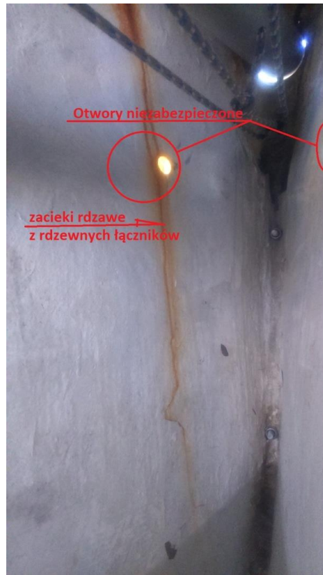
Zdjęcie 10 – zabudowa dziobu wykonana niezgodnie z dokumentacją
