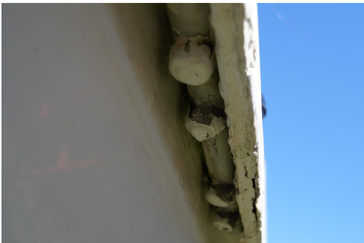
Zdjęcie 6 – uszkodzenia podwiązki wantowej
