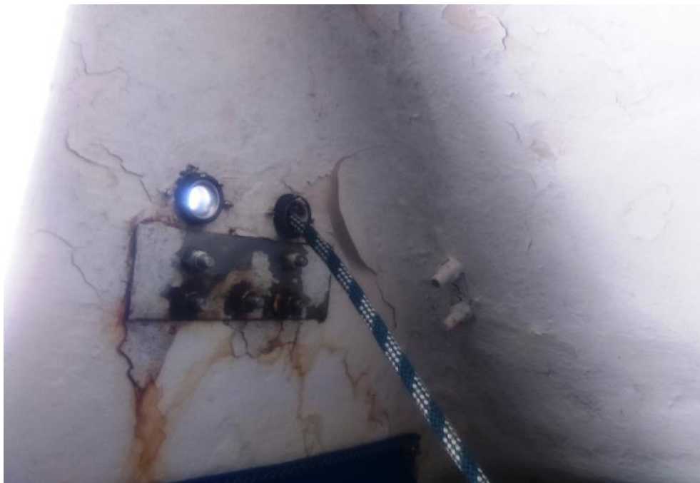
Zdjęcie 12 – rdzawe zacieki na skutek wykorzystania niewłaściwych materiałów
