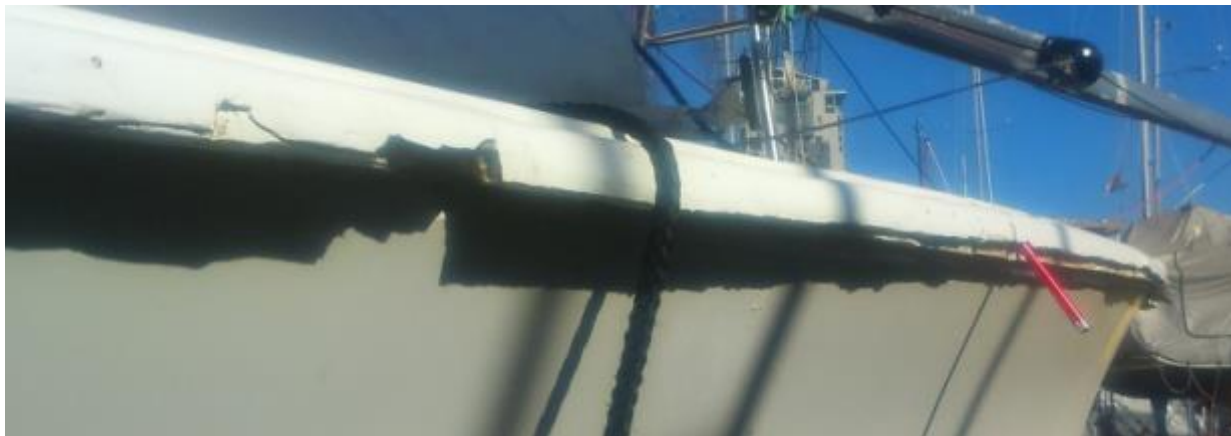
Zdjęcie 5 – uszkodzenia w połączeniu pokład - burta
